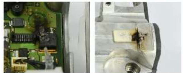
Abbildung 6 abgebrannter Transistorendstufe nach Pumpenschaden
